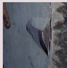
MANCANZE DI ADESIONE DELL'INTONACO (7)
