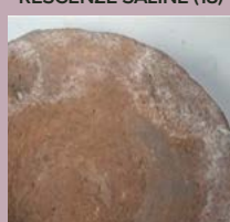
SBIANCAMENTI/EFFLO- RESCENZE SALINE (18)
