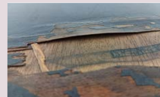
DISTACCHI DI PARTI DI RIVESTIMENTO (15)
